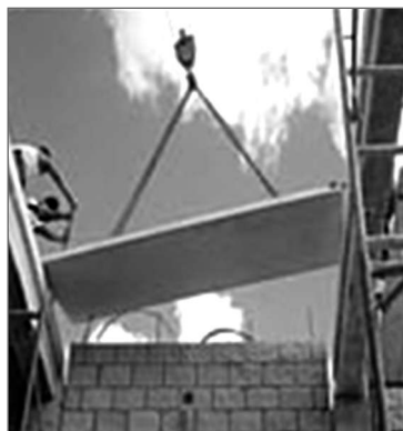
Figura 2. Losa prefabricada L-18 (proceso de montaje) Figure 2. Precast roofing, code L-18 (assembly process)
