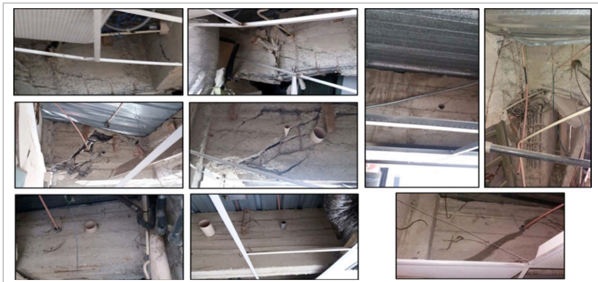
Figura 25. Grietas inclinadas que atraviesan los ductos en las vigas
