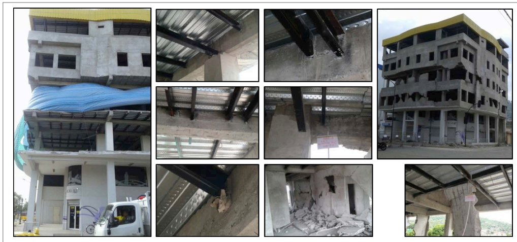
Figura 10. Edificio en ejecución, con irregularidad constructivas, no colapsado por el sismo
