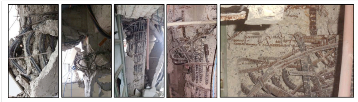
Figura 24. Irregularidades en la construcción de la edificación reveladas por el sismo
