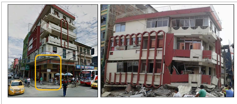
Figura 5. Edificio colapsado en la ciudad de Portoviejo sin columna de esquina en planta baja
