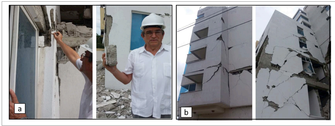
Figura 16. Altos espesores de enlucido generaron muros “sándwich” y atrajeron carga sísmica que no podían resistir
