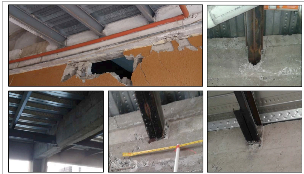
Figura 9. Evidencias de los desplazamientos de las vigas metálicas en los nudos híbridos
