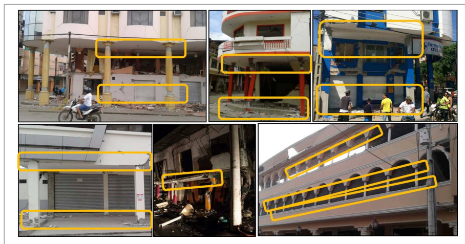
Figura 2. Edificaciones de la ciudad de Portoviejo que muestran las zonas L_o en que se concentra el fallo por corte y por confinamiento en columnas
