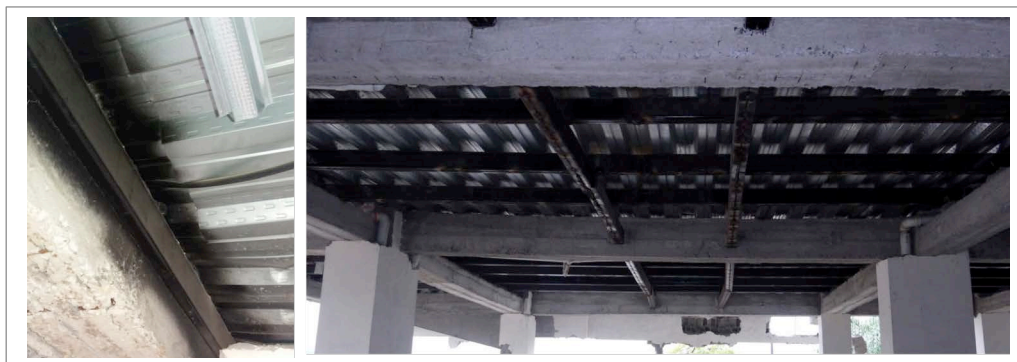
Figura 8. Fallo local por pandeo de láminas colaborantes y vigas metálicas
