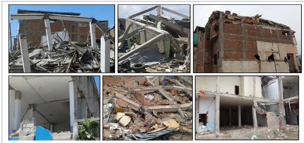
Figura 4. Edificaciones bajas colapsadas por fallos en columnas
