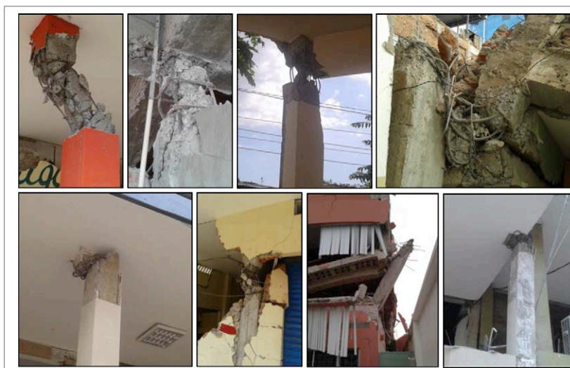
Figura 3. Indisciplinas tecnológicas, violaciones de normas y otros descuidos constructivos amplificaron los daños durante el sismo
