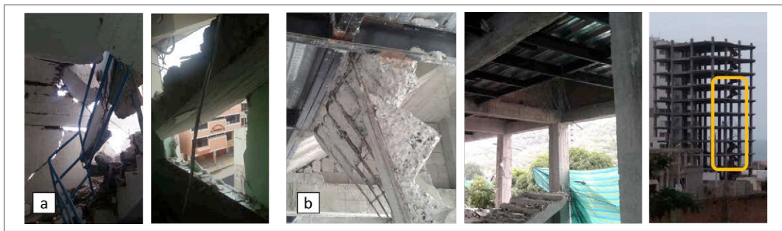
Figura 17. Inadecuada concepción de los anclajes de las escaleras y de su ubicación en «cajas» no estructurales
