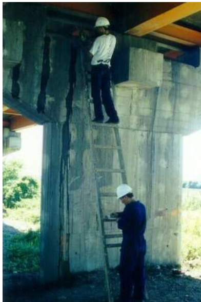
Figura 4. Medición de potenciales en pila hasta 4.5 m.
