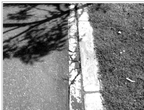
Figura 11. Fisuras concentradas sobre la línea de demarcación Figure 11. Cracking concentrated on demarcation line
